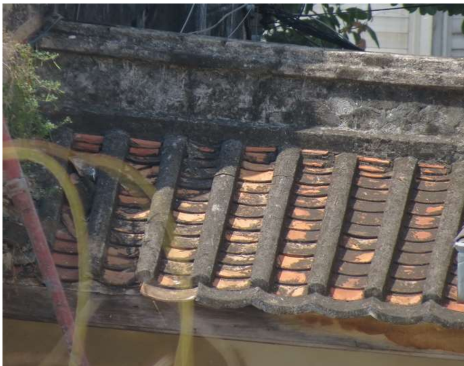
กระเบื้องมุงหลังคาแบบจินทาเทลิโอในปัจจุบันบนหลังคาชุมชนประตูกุศตะวันออก
